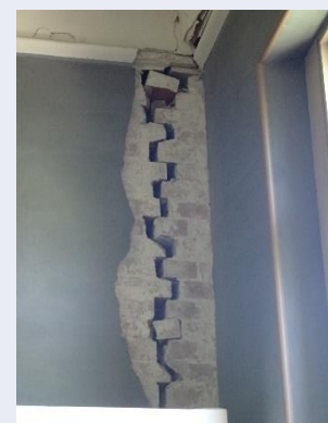
五高記念館北側壁の亀裂
