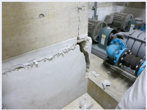
建物内部の亀裂
