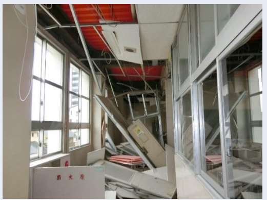
附属小学校廊下の天井崩落
