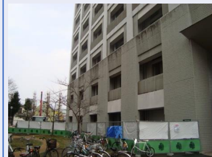
外壁タイル崩落の可能性がある部分は立入禁止措置
