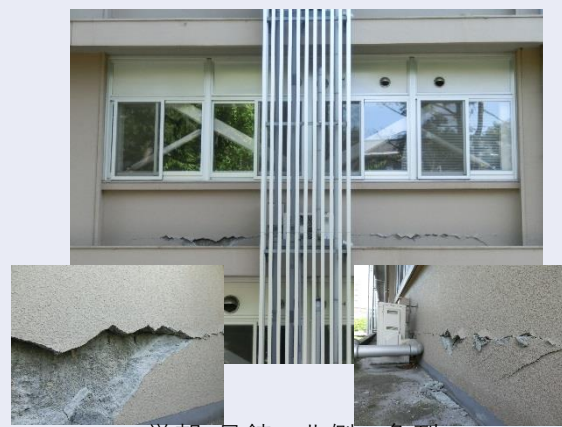
工学部1号館 北側の亀裂
