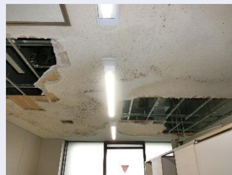
工学部研究棟I 天井からの水漏れ
