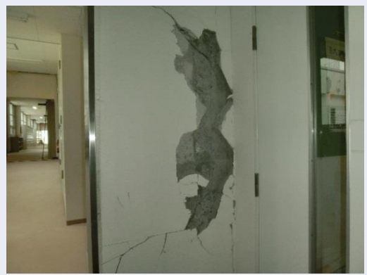
柱のひび割れ
