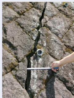
擁壁法面のひび割れ
