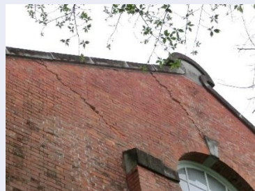
工学部研究資料館の東側壁の亀裂
