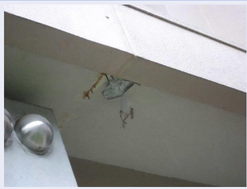
外壁の剥がれ
